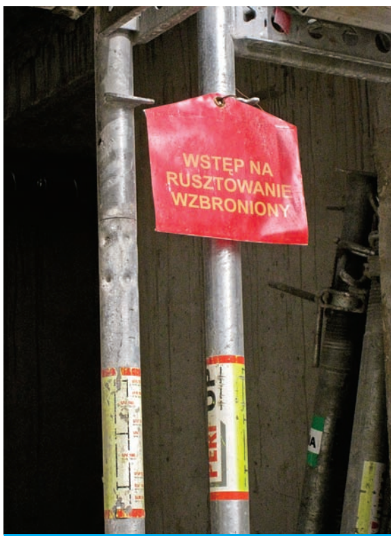
Fot. 45 Czytelne oznakowanie wyłączenia z eksploatacji.
