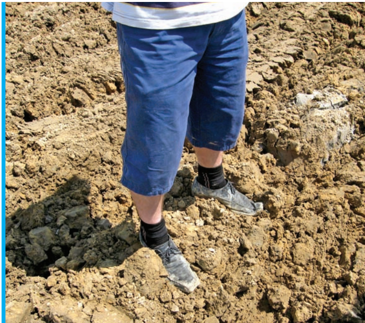
Fot. 52 Pracownik pracuje w niewłaściwym obuwiu.
