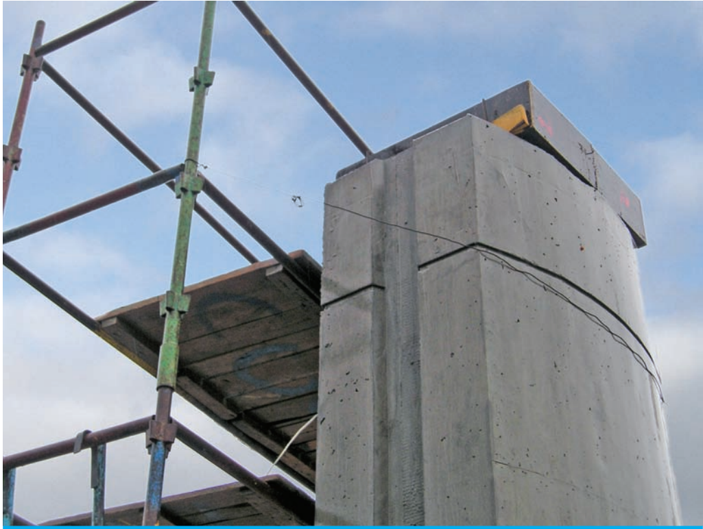
Fot. 20 Niebezpieczny sposób mocowania rusztowania.
