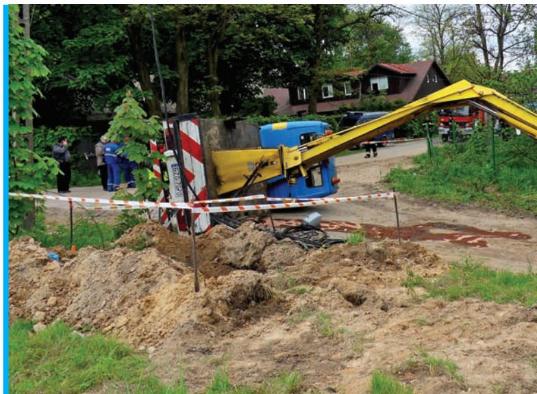
Fot. 3 i 4 Przyczyną wypadku było niewłaściwe wypoziomowanie urządzenia i przeciążenie pomostu.
